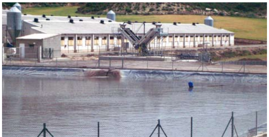
Separador sòlid - líquid instal·lat a la pròpia explotació
